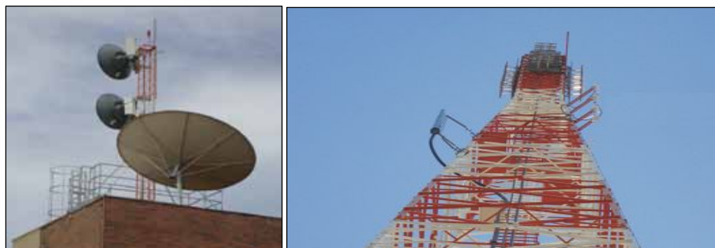
Ilustrações 10 e 11: Antena Parabólica para recepção de Sinal via Satélite da TV Brasil e antenas de Transmissão – Tx – dos dois links de microondas instaladas no Sítio de Operação Estúdio da TV UFG (Foto: OLIVEIRA, T. M.) e Antena de Transmissão UHF, modelo SLOT 12 fendas, localizada no Morro do Mendanha (Foto: SIQUEIRA, Carlos – Ascom/UFG).
