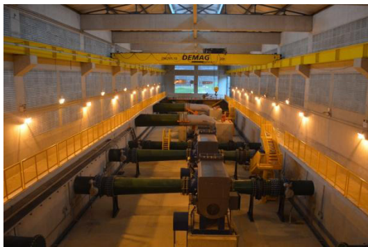
Figura 1 - Casa de máquinas responsável pelo bombeamento de água bruta
