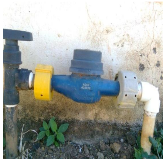
Figura 3 – Hidrômetro mal posicionado
