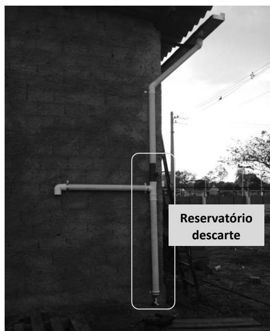
Figura 3 – Sistema de Captação com intervenção de telha de fibrocimento, com destaque no reservatório de descarte Fonte: pesquisa dos autores
