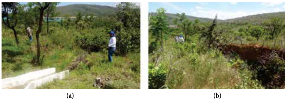
Figura 11. Processos erosivos no entorno dos reservatórios: (a) Lançamento de água captada em estrada marginal ao reservatório de Furnas sem dispositivos de dissipação de energia (Fonte: Diego T. F. Nascimento, 2015); (b) Incisão erosiva desenvolvida pelo lançamento de água captada em estrada marginal ao reservatório de Furnas (Fonte: Diego T. F. Nascimento, 2015).
