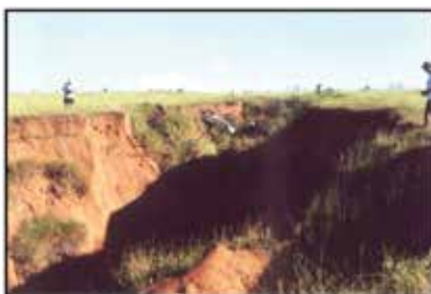
Figura 4. Erosão em sulco verificada nas margens do reservatório de Barra Bonita (Fonte: MRS, 2001).
