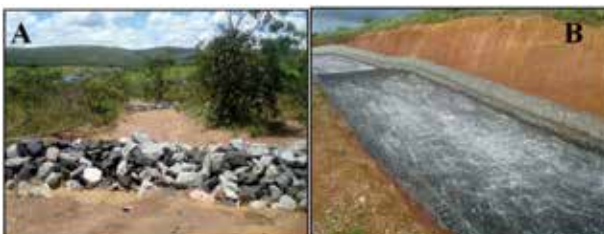
Figura 16. Entrocamento de pedras (A) e colchão reno (B) no entorno da UHE de Batalha. Fonte: Maurício Martines Sales (2013).
