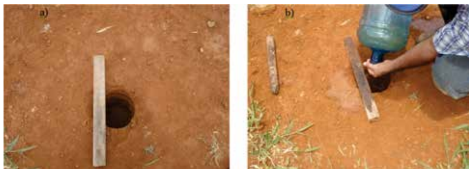
Figura 11. Ensaio de permeabilidade in situ . a) escavação de furo cilíndrico; b) ensaio de infiltração de água no furo em função do tempo. Foto: Maurício M. Sales (2012).
