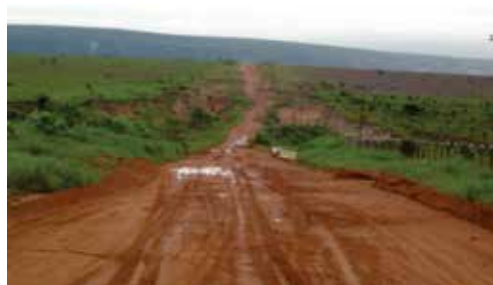
Figura 8. Trecho mostrando que a erosão se intensifica na parte mais baixa da encosta. Rodovia em Tangará da Serra, MT (Foto: Wilson Conciani).
