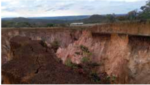
Figura 7. Erosão gerada em área de empréstimo junto à BR-060. Foto: 21 ago. 2016. (Foto: José Camapum de Carvalho).
