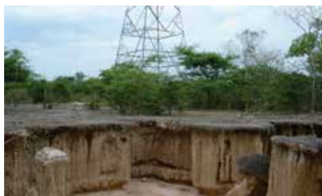
Figura 4. Erosão na linha de transmissão Jaurú – Coxipó, decorrente da limpeza da faixa de domínio da obra. Jangada, MT (Foto: Wilson Conciani).
