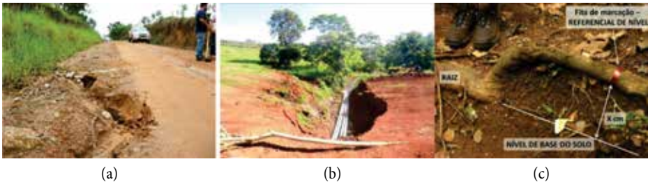
Figura 15. Erosão linear concentrada no leito de estrada rural em Alterosa, MG (a). Obra hidráulica mal dimensionada, em Buriti Alegre, GO (b). Evidência de perda de solo em fragmento florestal urbano protegido, sob solo argiloso, no Jardim Botânico de Goiânia (c) (Fotos: Renata S. Momoli).
