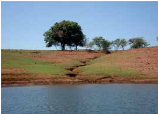
Figura 11. Vista da margem exposta na UHE de Itumbiara, com sinais de erosão em descida d'água. Fonte: Diego Tarley Ferreira Nascimento (2015).
