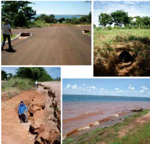
Figura 2. Erosão, com carreamento de sedimentos para o reservatório da UHE-Itumbiara (GO), provocada por lançamento inadequado de águas pluviais oriundas de condomínio às margens do reservatório. Foto: Maurício M. Sales (2015).
