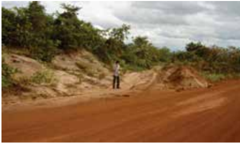
Figura 18. Abaulamento do leito carroçável e o direcionamento do fluxo para região de dissipação da energia (Foto: Wilson Conciani).
