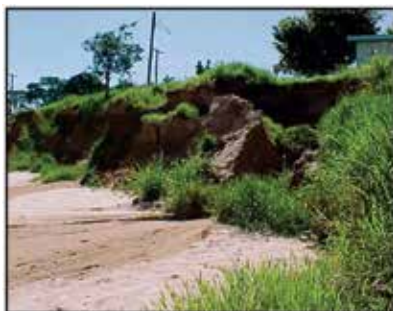
Figura 3. Escorregamento verificado nas margens do reservatório de Barra Bonita (Fonte: MRS, 2001).
