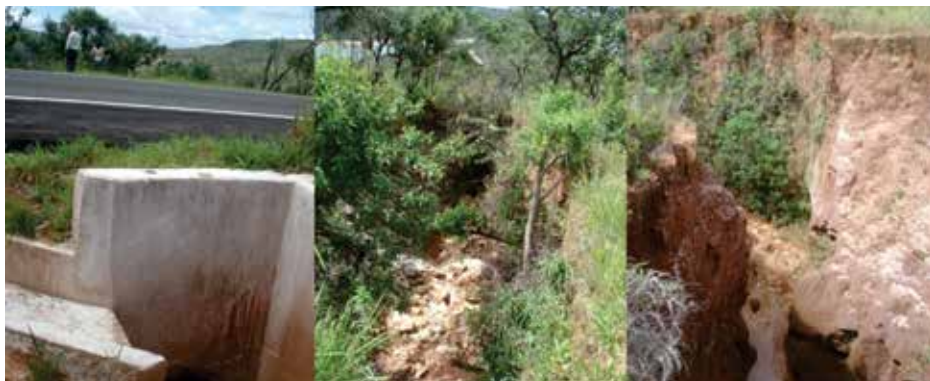
Figura 12. Lançamento de água pluvial de uma rodovia causando erosão próxima ao reservatório da UHE-Furnas(MG). Foto: Maurício Martines Sales (2013).
