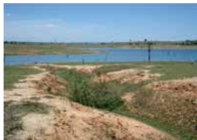
Figura 9. Erosão de margem do reservatório. (Foto: Maurício Martines Sales).
