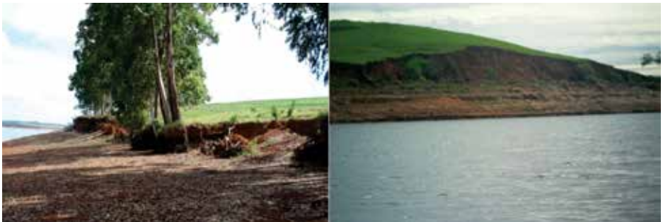
Figura 4. Solapamento da base de taludes provocando movimento de massa e queda de vegetação. UHE-Furnas(MG). Foto: Maurício M. Sales (2015).
