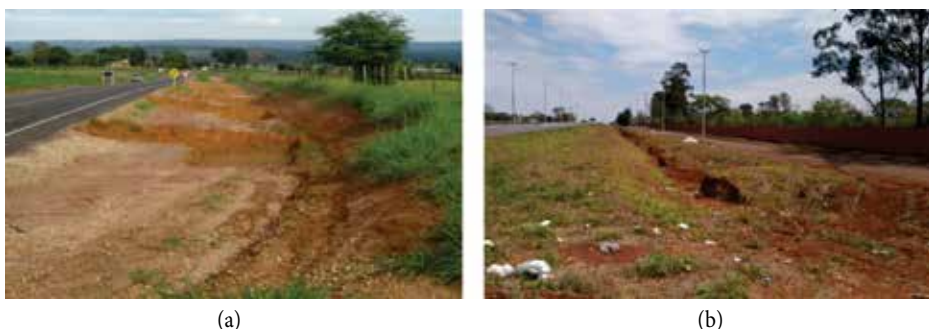
Figura 20. Exemplos de situações com uso de diques: (a) Uso de diques de contenção do fluxo nas margens de rodovias (Foto: Wilson Conciani); (b) Comprometimento dos diques por processos erosivos, margem da GO-020 (Foto: José Camapum de Carvalho).
