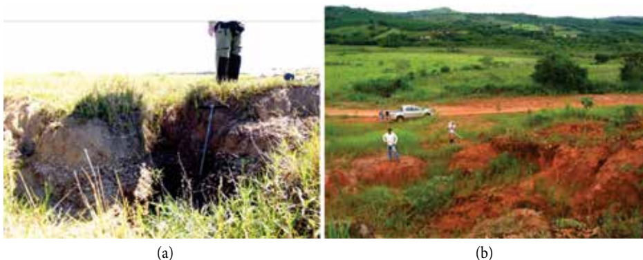
Figura 9. Erosão concentrada na forma de ravina em terrenos elevados e aplainados com fraca dissecação, Município de Buriti Alegre, GO (a). Erosão em ravinas em encosta íngreme, Campos Gerais, MG (Fotos: Renata S. Momoli).
