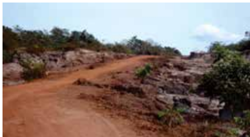
Figura 6. Erosão ao longo da BR 163, região da serra do Cachimbo no sul do Pará (Foto: Wilson Conciani).
