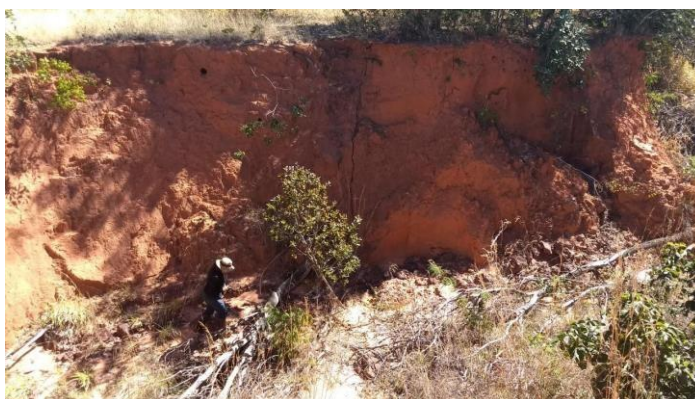
Figura 4 — Erosão linear constatada em campo Foto: RODRIGUES, D. L. (2017).
