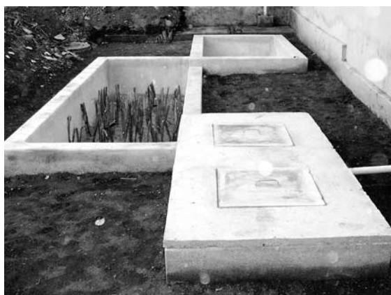
Unidade de tratamento de esgoto doméstico concluída
