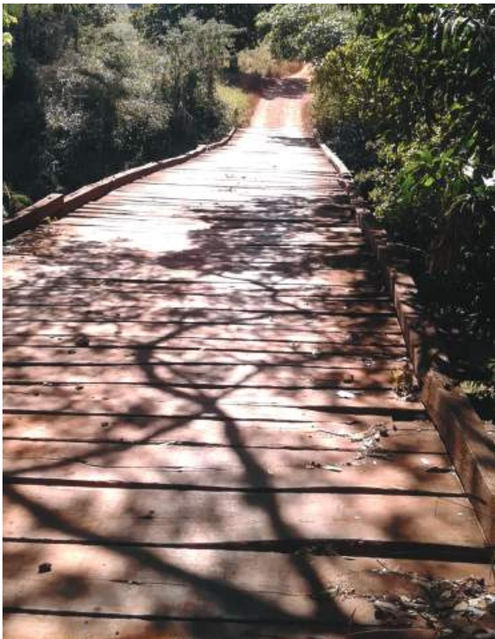
Ponte de madeira sobre o rio Bugre na sede do distrito de Buenolândia, Arraial da Barra, 2018
