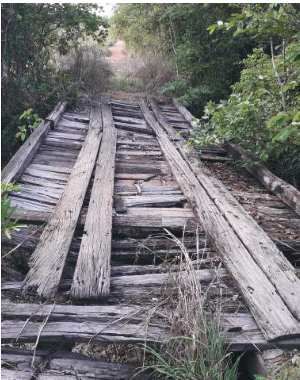
Ponte de madeira sobre o córrego Mazagão ao lado do bar do Elton, Arraial da Barra, 2019
