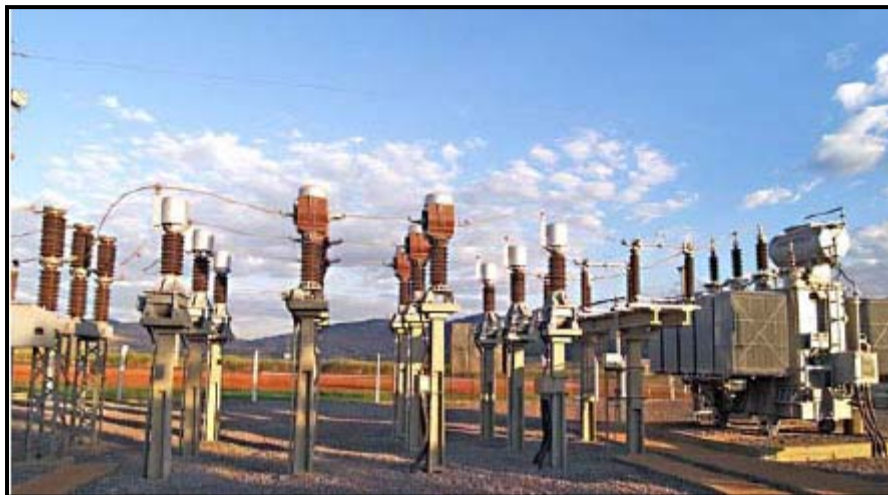
Figura 7: Rede elétrica de transmissão – usina Jalles Machado. Foto: Arquivo da usina.
