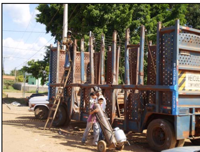
Figura 26: Serviço de soldagem a caçambas de transporte de cana. Itapaci, 13 de maio de 2009. Foto: Rangel G. Godinho.
