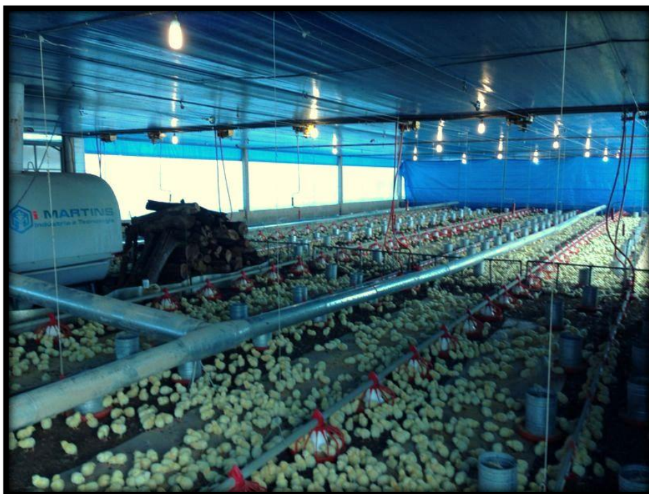
Figura 3. Tubulações do aquecedor a lenha com ventilação forçada.
