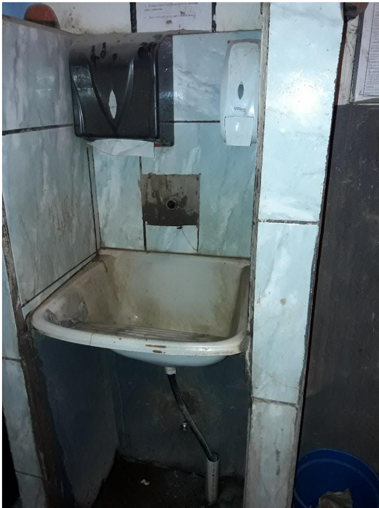
Figura 2. Pia no interior da fábrica de ração com a torneira removida.
