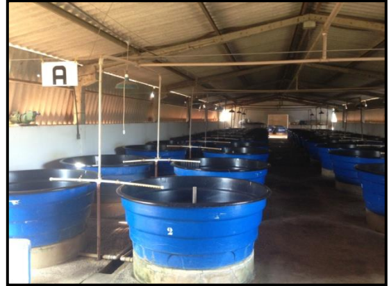
Figura 2 - Barracão com caixas de polietileno de 1000 l
