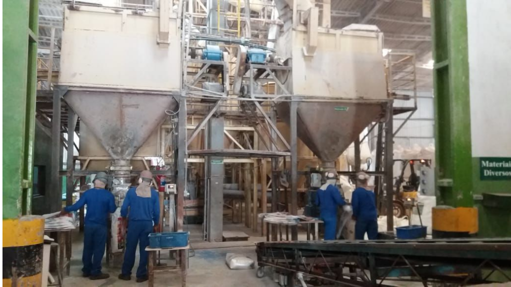
Figura 7 – Silos de ensaque, fábrica de suplemento mineral Fonte: Arquivo pessoal.
