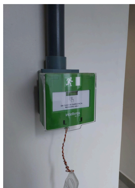
Imagem 111: Sistema de emergência
