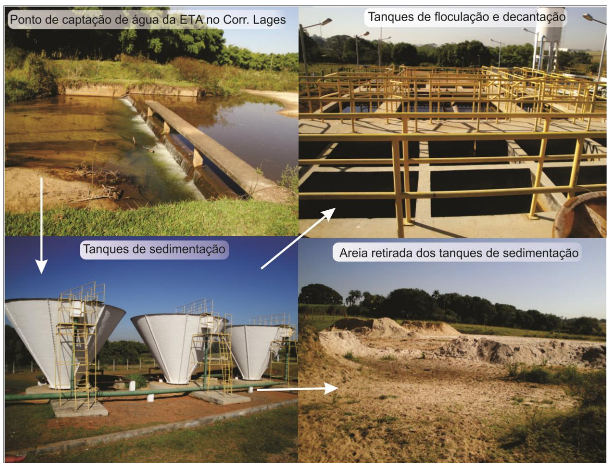
Figura 25 – Imagens do sistema de captação ETA-Lages em Aparecida de Goiânia.
