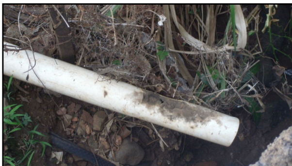
Figura 50: Lançamento de Esgoto. Fonte: PEREIRA, 2011.
