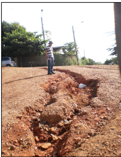
Figura 31: Processos de Ravinamento em Área Urbana Sem Pavimentação. Fonte: PEREIRA, 2011.
