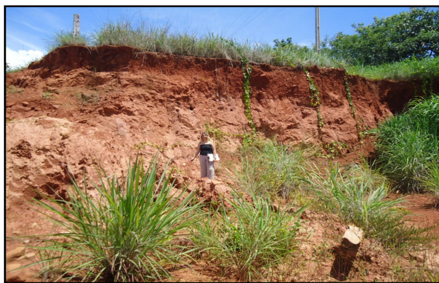
Figura 42: Movimento de Massa Associado à Área de Empréstimo, Minaçu(GO). Fonte: PEREIRA, 2011.
