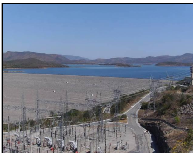
Figura 26: Foto parcial da Usina de Serra da Mesa
