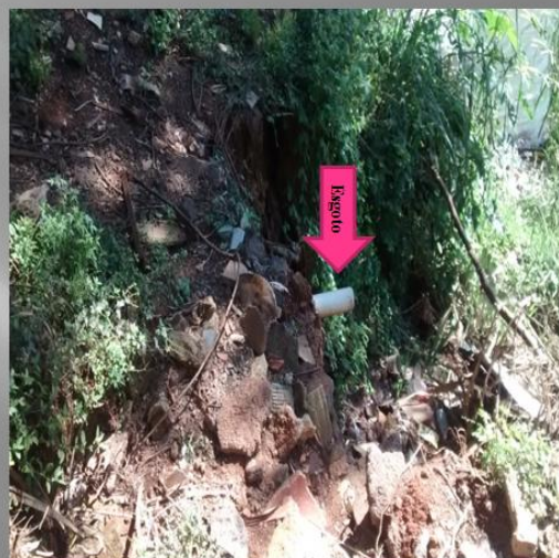
Figura 13: Pimenta, 2015. Lançamento de esgoto clandestino e riscos de solapamento da margem do córrego nas proximidades da ponte da av. 2ª Radial, S. Pedro Ludovico, Goiânia-GO.
