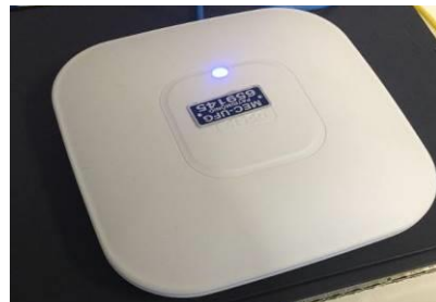
Foto 2: Ponto de acesso para rede sem fio
