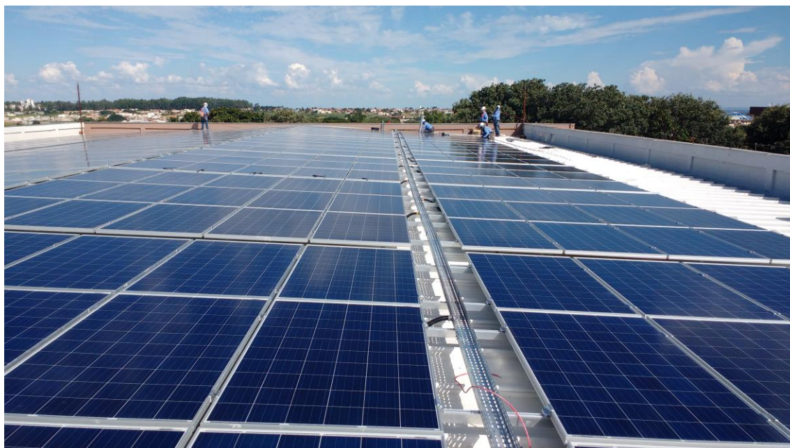
Foto 17: Painel fotovoltaico localizado no telhado do Auditório Paulo de Bastos Perillo
